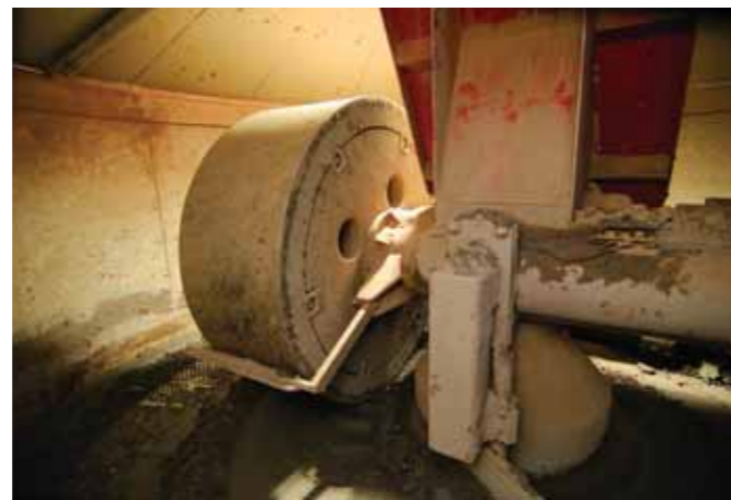
Kolový mlýn: Připravená směs se musí dále nadrtit. K tomu se používá kolový mlýn, který dokáže umlít 95 až 96 tun materiálu za hodinu. Jeho kolo má hmotnost až 20 tun, touto váhou protlačuje směs skrz rošty a tím ji drtí na požadovanou velikost. Pod kola mlýnu hrnou směs stěrky. Jiné pak narušují rozdrčenou vrstvu, aby nedošlo k ucpání roštů.
