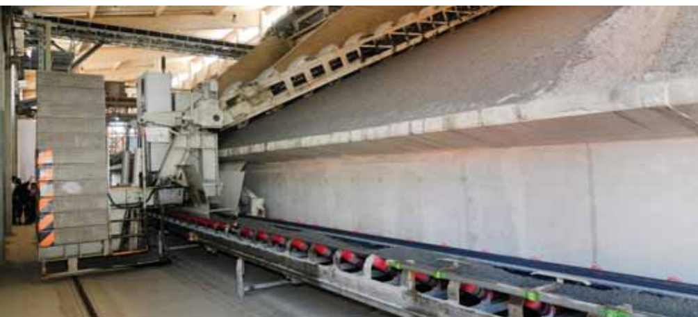
Odležárna suroviny: Nadrcená směs se nechá potřebný čas odležet a poté se nahrne korečkovým bagrem na pásový dopravník, který ji dopraví k lisu. Zásobníky jsou koncipovány podle sypaného úhlu materiálu, takže směs se z nich sama nesouává dolů. Stejně tak jako většina cihelny i korečkový bagr je plně automatizovaný, stačí jej pouze zavést do příslušného boxu a o zbytek se postará sám.
